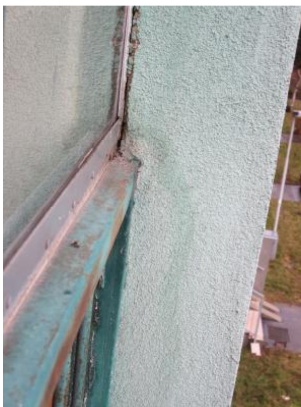
FOTO 18 : Zatékání do systému dodatečného zateplení v nevhodně provedeném detailu u posuvného zasklení lodžie
