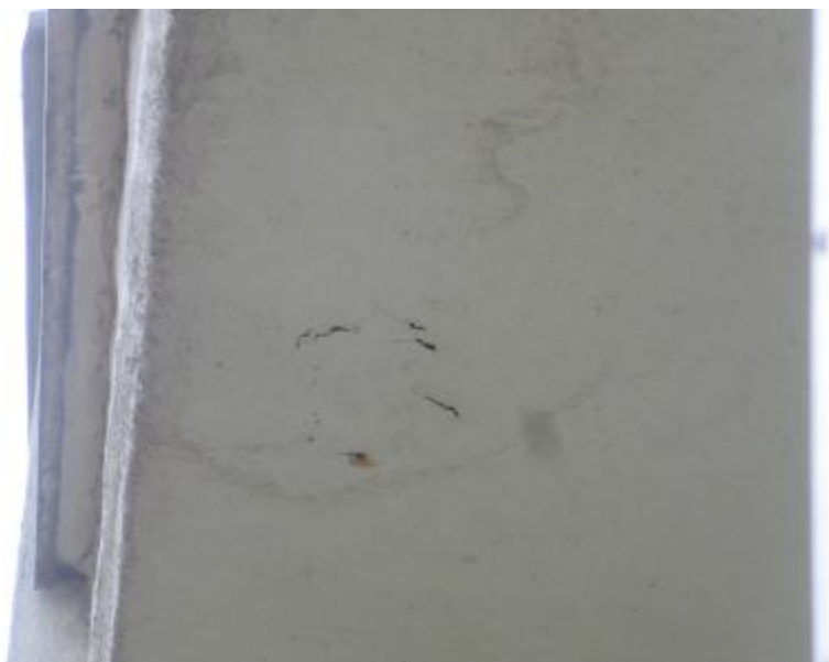
FOTO 17 : Prosakování srážek na podhled stropu v lodžii
