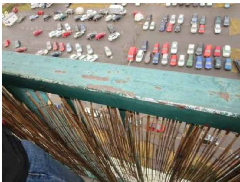
FOTO 9 : Odlupující se ochranný nátěr zábradlí. Lokální projevy koroze
