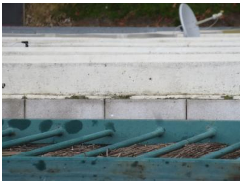
FOTO 10 : Vadný okraj podlahy lodžie s ukončením dlažby na plechové okapnici
