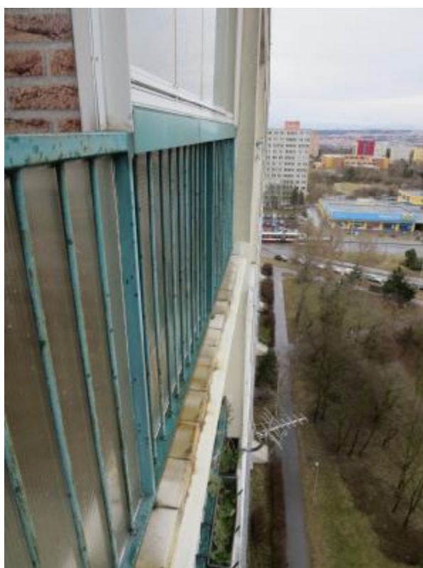
FOTO 12 : Koroze plechové okapnice na okraji dlažby, stopy po stékání korozních zplodin ze zábradlí po dlažbě
