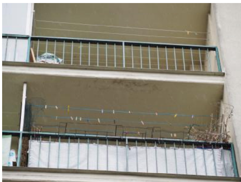
FOTO 5 : Prosakování vlhkosti z dutiny stropního lodžiového dílce v místě kotvení sloupku zábradlí
