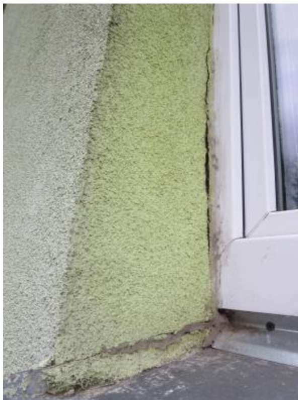
FOTO 6 : Trhlina mezi ukončením omítkových vrstev u rámu okna a v místě ukončení oplechování na ostění
