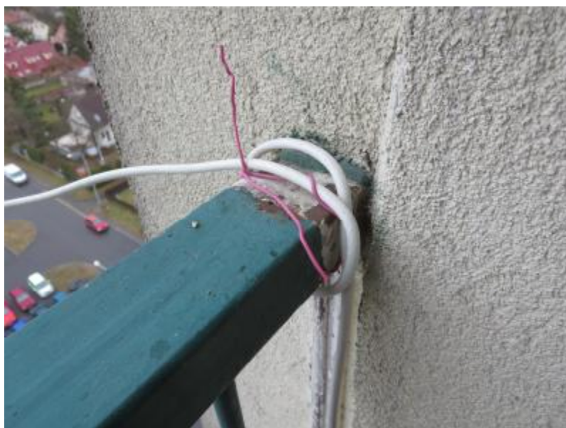
FOTO 8 : Místo navaření nového zábradlí na staré u boční stěny lodžie
