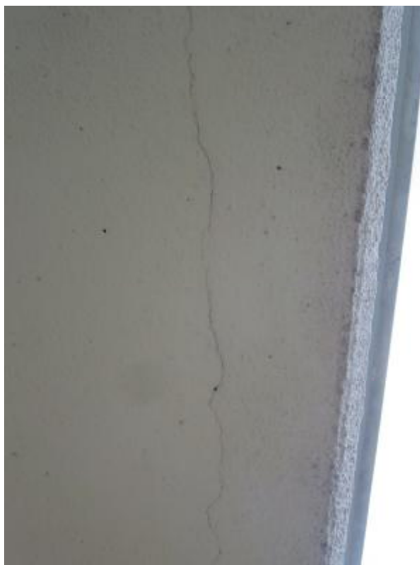
FOTO 16 : Trhlina v místě dutiny stropního lodžiového dílce – pravděpodobně výrobní vada dílce
