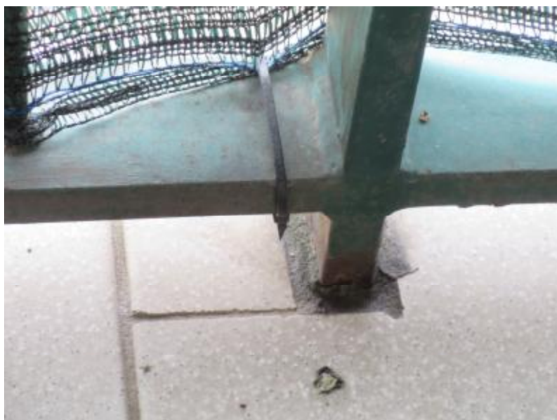
FOTO 14 : Koroze profilu sloupku zábradlí v místě kotvení do podlahy
