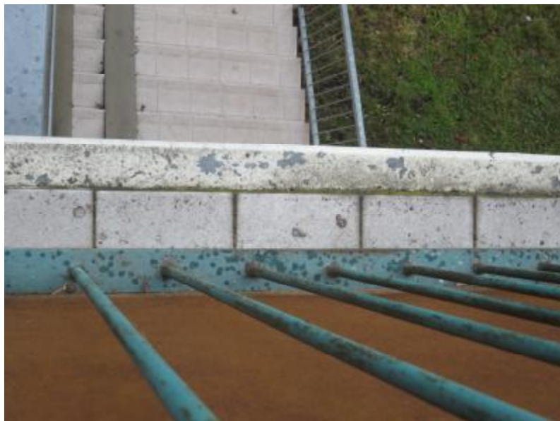
FOTO 15 : Koroze výplně spár na okraji dlažby. Zelená řasa signalizuje přítomnost vlhkosti ve spáře mezi okapnicí a dlažbou
