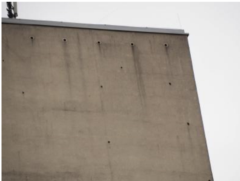
FOTO 3 : Detail stop po vytékání kondenzátu z větracích otvorů střechy a otvory vyklované datlíky v horní části severního štítu
