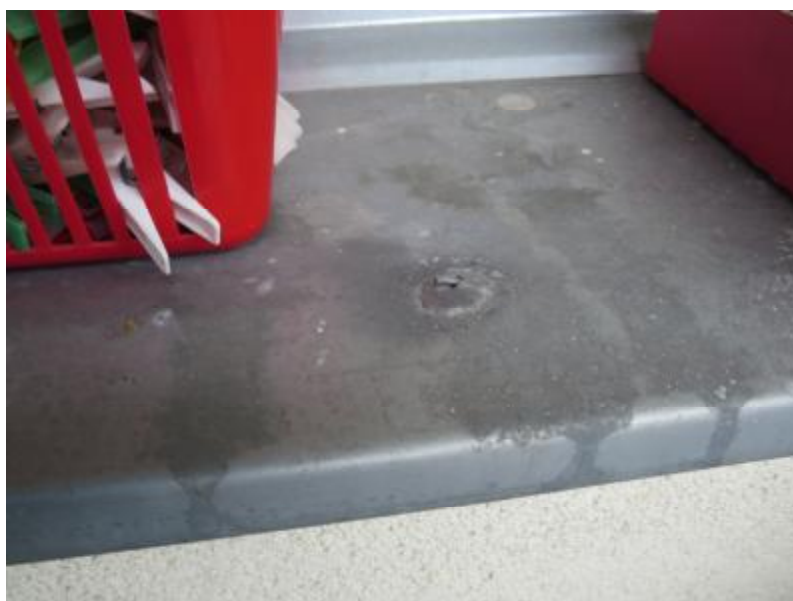
FOTO 11 : Uvolněné kotvení oplechování parapetu okna na lodžii
