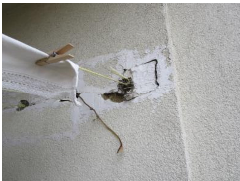
FOTO 13 : Poškození systému dodatečného zateplení při montáži konzoly pro šňůry na prádlo v lodžii
