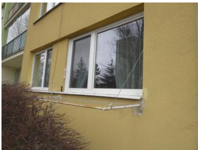
FOTO 7 : Neodborná montáž podokenního sušáku. Nad okny je patrný nezakrytý plechový osazovací profil původních dřevěných oken.
